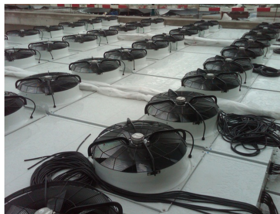
Centrale de combustion des déchets, KVA Winterthur, Suisse
