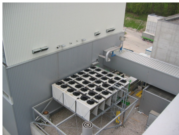
Centrale de combustion des déchets, KVA Wels
